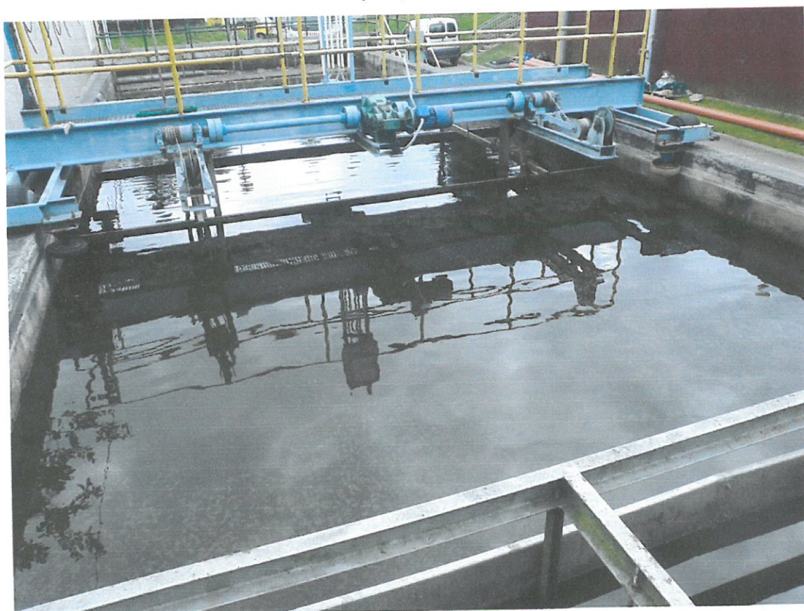
Ryc. 3. Widok na osadnik wtórny na oczyszczalni ścieków w Polańczyku (10.07.2015 r.).
