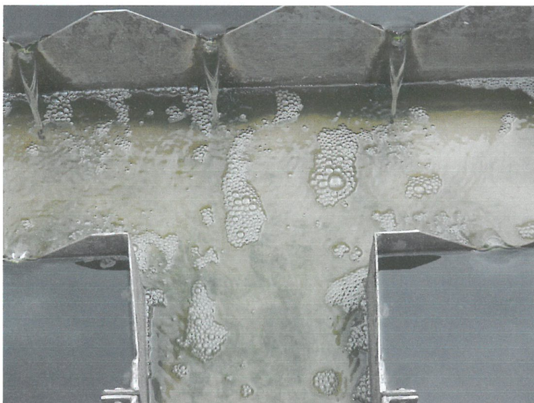
Ryc. 2. Zbliżenie na korytka odprowadzające ścieki z osadnika wtórnego na oczyszczalni ścieków w Polańczyku (10.07.2015 r.).
