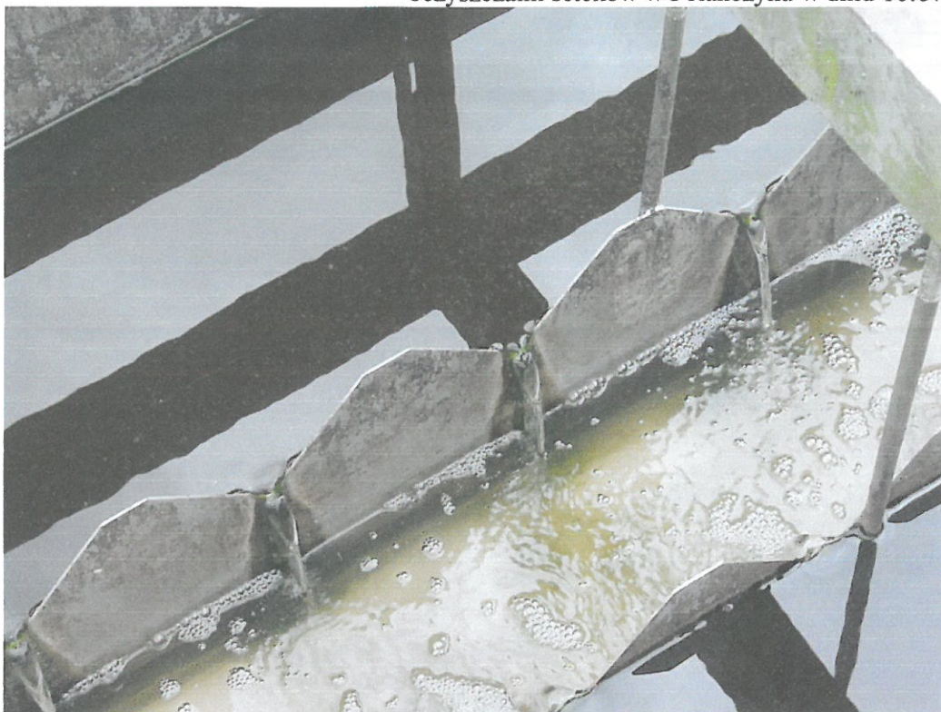
Ryc.1. Widok na korytka odprowadzające ścieki z osadnika wtórnego na oczyszczalni ścieków w Polańczyku (10.07.2015 r.). Widoczne beżowe zabarwienie ścieków i osady wynoszone wraz ze ściekami z osadnika.
